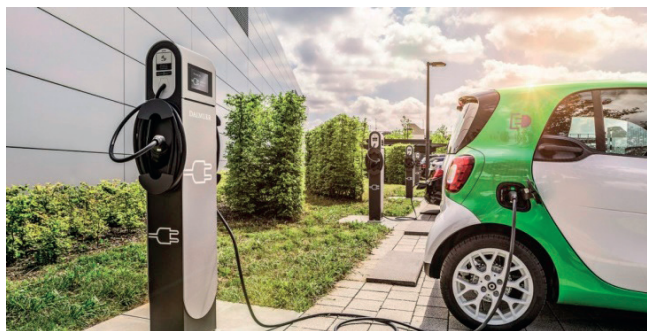
Dobíjecí stanice pro elektromobily
